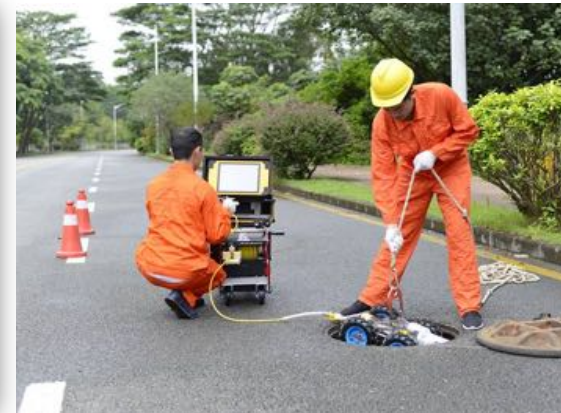
现有管道机器人
